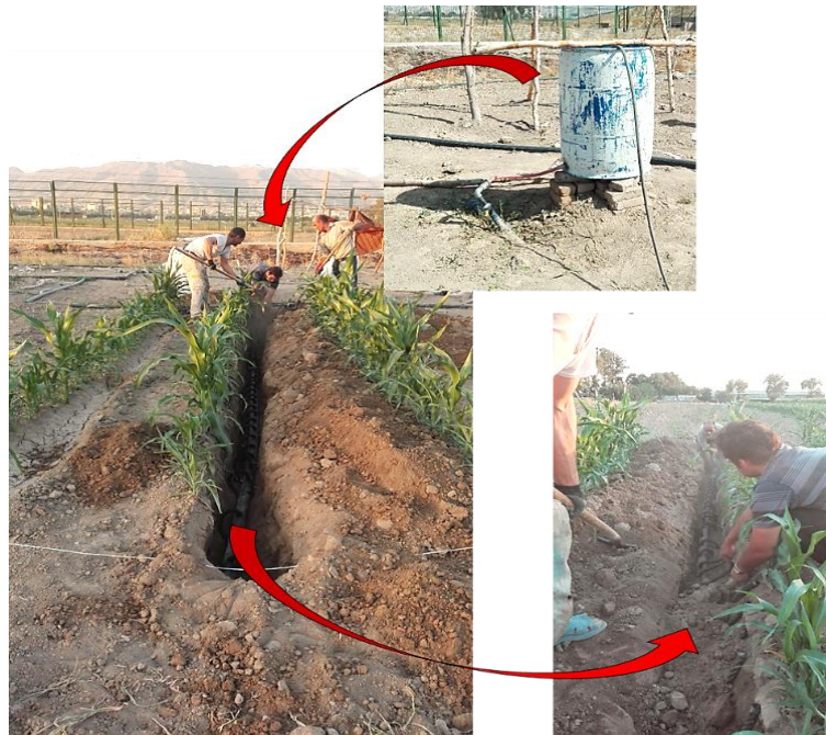
شکل ۴- کارگذاری لوله در عمق ۰/۵ m و اتصال به منبع آب و عمودی قرار دادن فیتیله‌ها کنار ریشه‌ها و پرکردن شیار Fig. 4 Placing the pipe at a depth of 0.5 m and connecting to water reservoir and setting the wicks vertically next to the roots of the plants and filling the furrow
